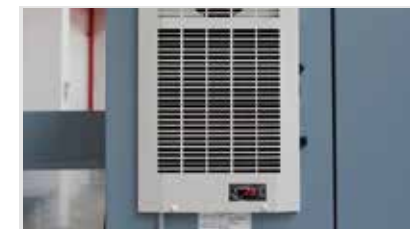
02 电控系统空调系统
