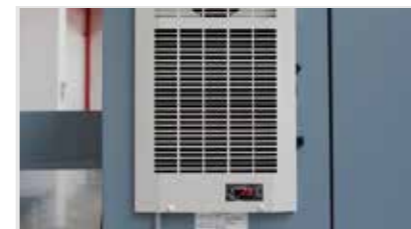
02 电控系统空调系统
